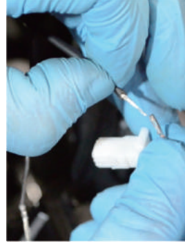
④ 押し外した水色メス端子と付属配線アース部ハーネスのオス端子を接続し、付属の伸縮チューブにて保護します。
